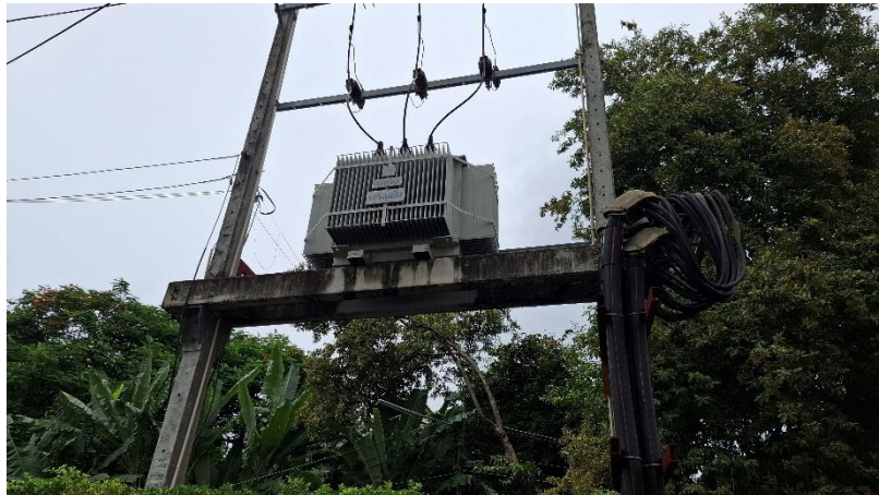
หม้อแปลงขนาด 1000 kVA
